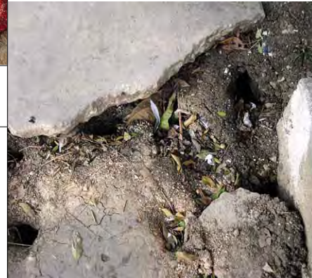
FIGURA 35. Daños de rata parda en acera peatonal.
