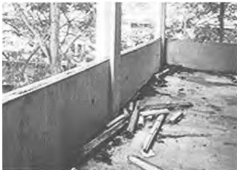
Edificios en mal estado técnico.
