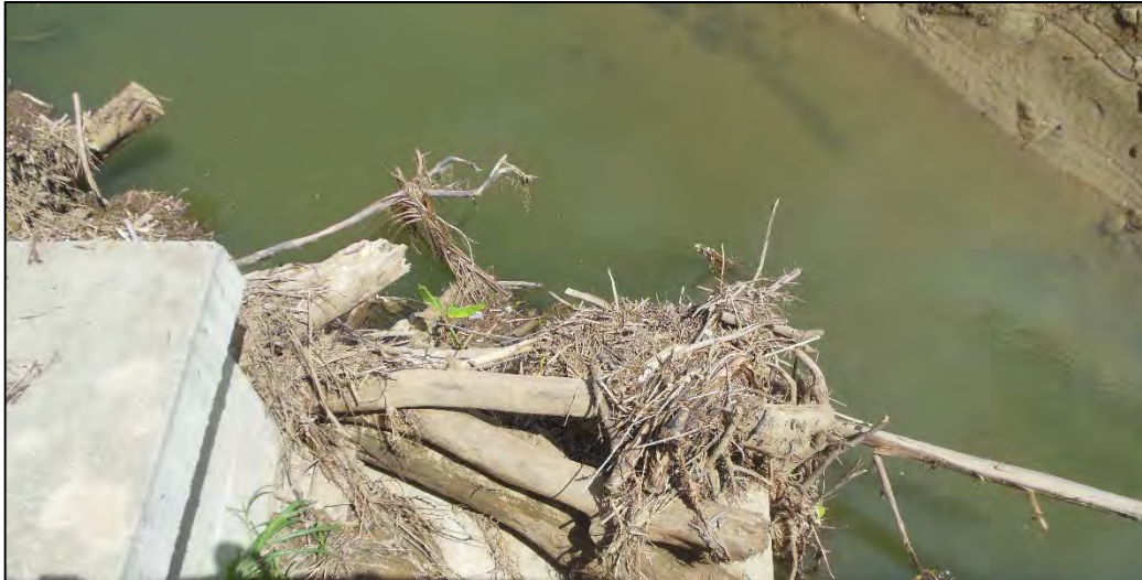
Fig. 6.2.4-1. Huella del agua en pilar de un puente
