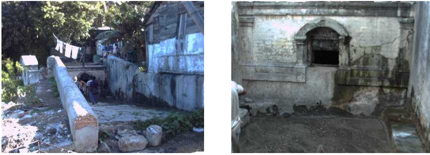
Fig. 30 y 31- Vista general y ampliada de la Fuente del Chorro de los Pocitos después de la higienización del lugar efectuada por un grupo numeroso de vecinos. Se debe priorizar la atención para evitar que continúe su deterioro.
