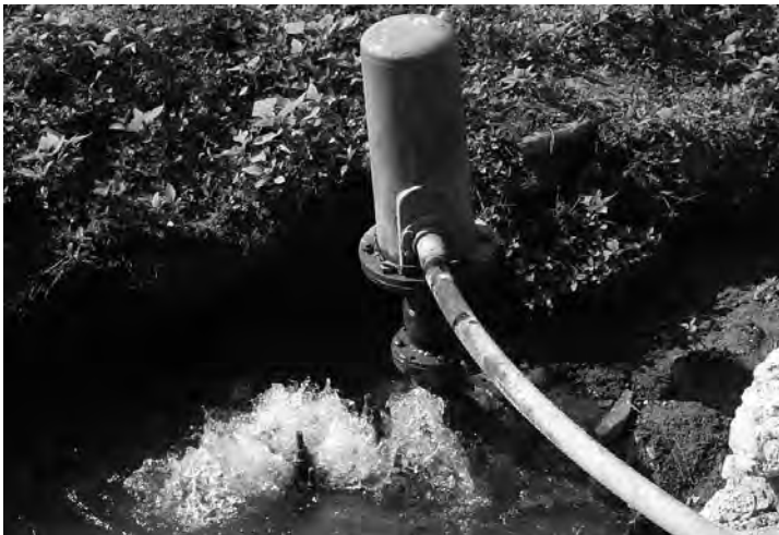
Figura 4. Bombeo por ariete hidráulico.
