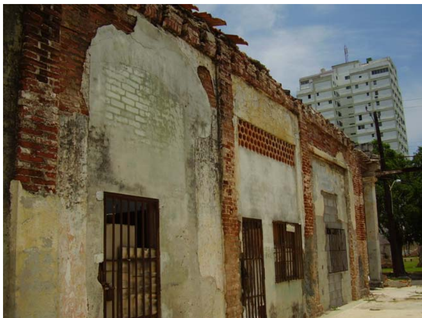
Foto 5. Viviendas en mal estado técnico constructivo en la intersección de las calles Calzada y 2.
