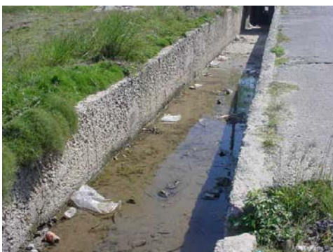
Fig. 84. Canal deteriorado con residuales sólidos
