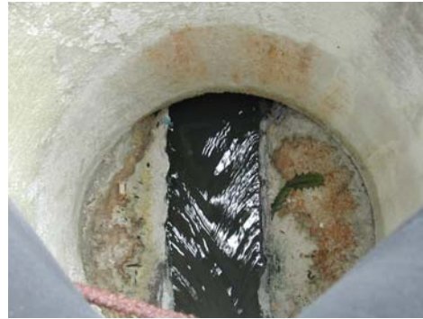
Fig. 74 Aguas negras del tanque séptico de Peñas Altas que vierte directamente al río.
