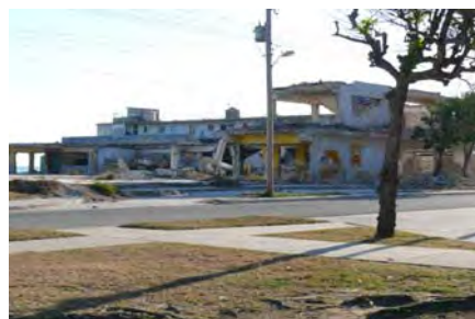
Foto 46. Edificaciones ubicadas en la línea de costa, deterioradas por la falta de mantenimiento
