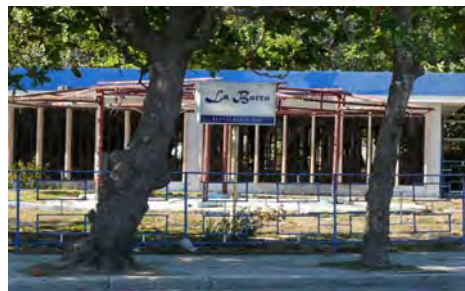
Foto 44. Restaurante la Barca, en mal estado técnico constructivo.
