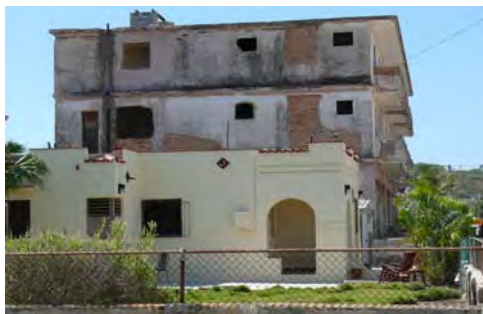
Foto 43. Manifestaciones del deterioro y de la falta de reparaciones
