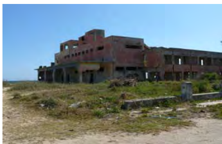
Foto 45. Edificaciones ubicadas en la línea de costa, deterioradas por la falta de reparaciones
