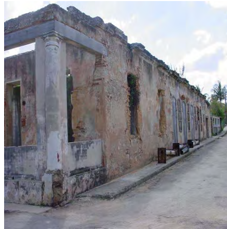
Foto 11. Inmueble en mal estado técnico-constructivo.
