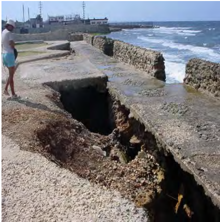
Foto 10. Acera en mal estado técnico-constructivo
