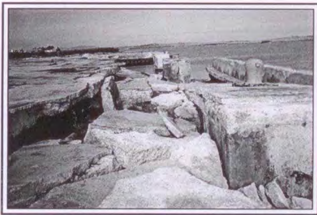
Figura 9. Derrumbes en los atraques. (Fuente: fotografía tomada por el autor).
