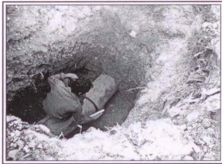
Figura 6. Separaciones de tuberías de hierro. (Fuente: fotografía tomada por el autor).
