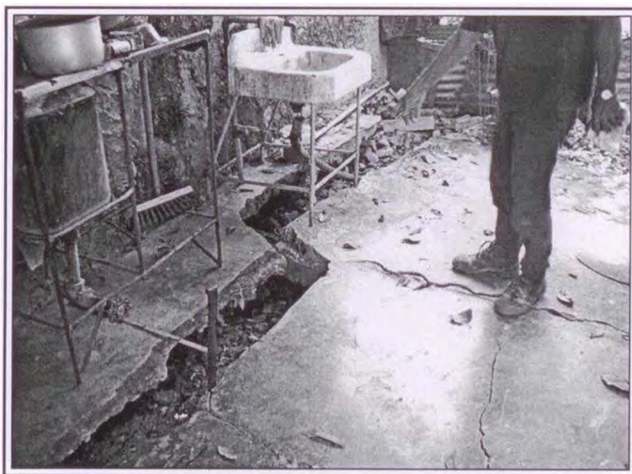
Figura 56. Ascenso, fracturas y corrimientos de infraestructuras. (Fuente: fotografía tomada por el autor).
