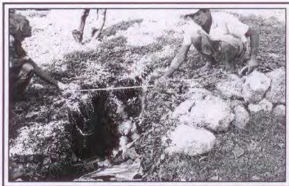
Figura 49. Grieta de 0.510 metros. (Fuente: fotografía tomada por el autor).
