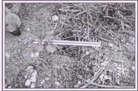
Figura 48. Grieta de 0,240 metros. (Fuente: fotografía tomada por el autor).
