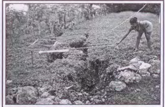
Figura 50. Grieta de 1,340 metros. (Fuente: fotografía tomada por el autor).
