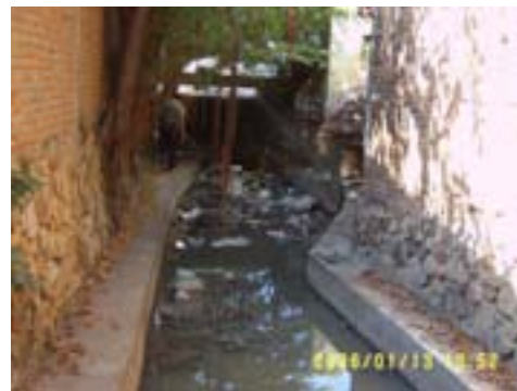
Figura 4. Vertimiento de aguas residuales
