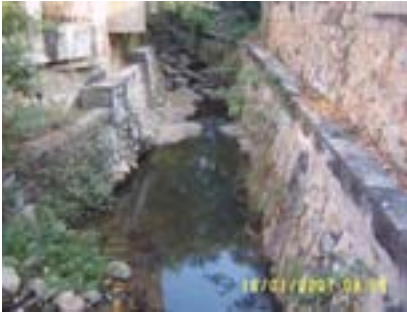
Figura 7. Socavación muros de protección
