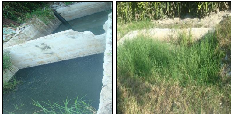
Fig. 18. Condiciones deficientes del tanque séptico del reparto Peñas Altas
