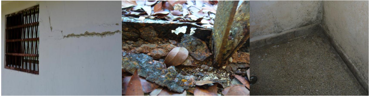
Figura 3. Deterioro de las condiciones constructivas
