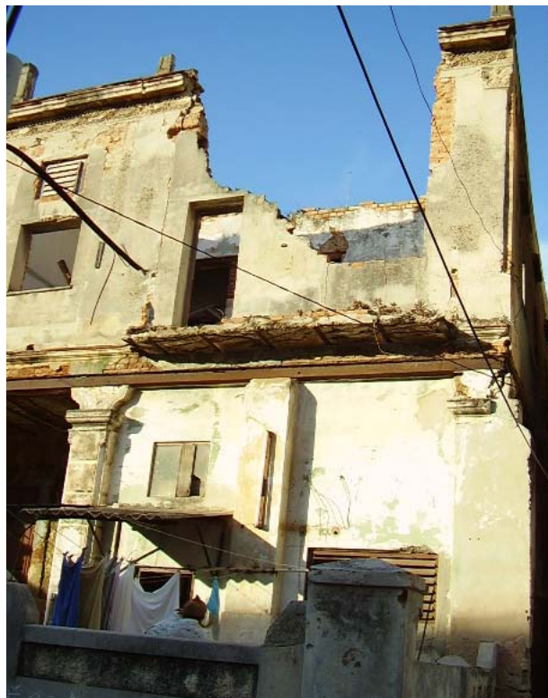
Figura 2. Edificación en mal estado técnico y constructivo en la barriada capitalina de El Vedado. Foto tomada por el autor.
