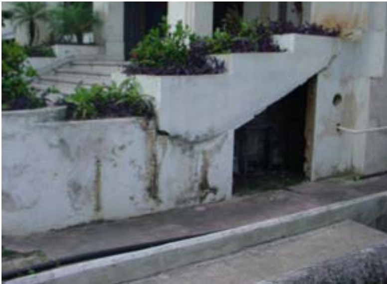
Fig.3 Afectaciones de construcciones por los movimientos y otros procesos geológicos.
