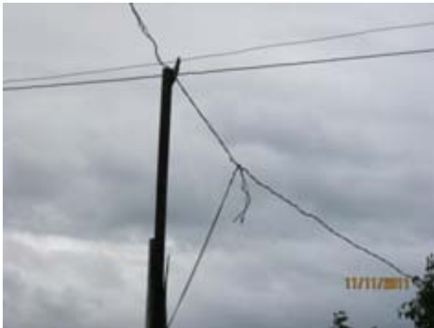
Foto 12. Tendederas eléctricas improvisadas por los moradores
