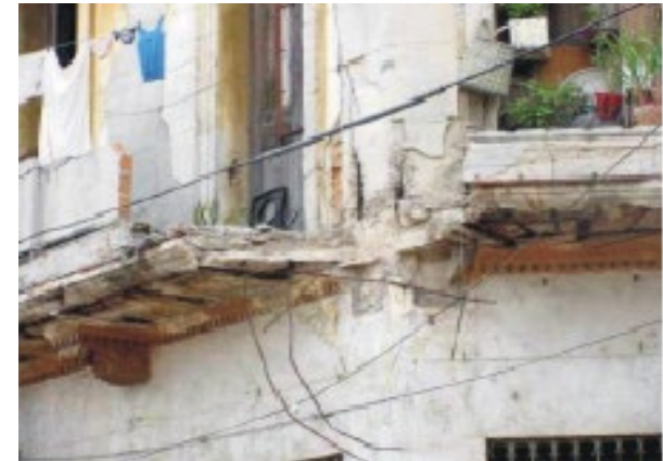
Derrumbe de balcones
