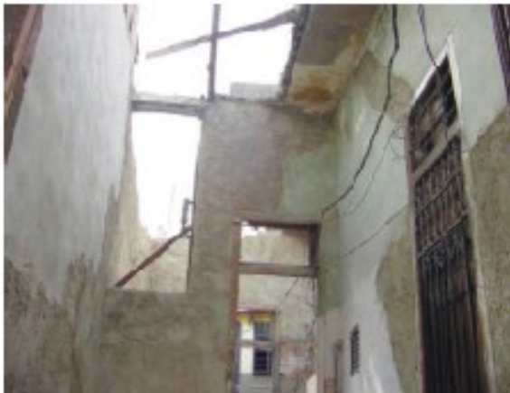
Derrumbe del techo
