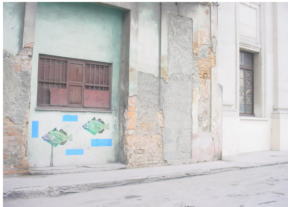
Deterioro de paredes
